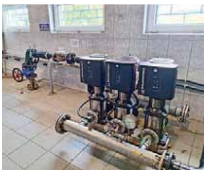
» Stacja Uzdatniania Wody w Liścu
