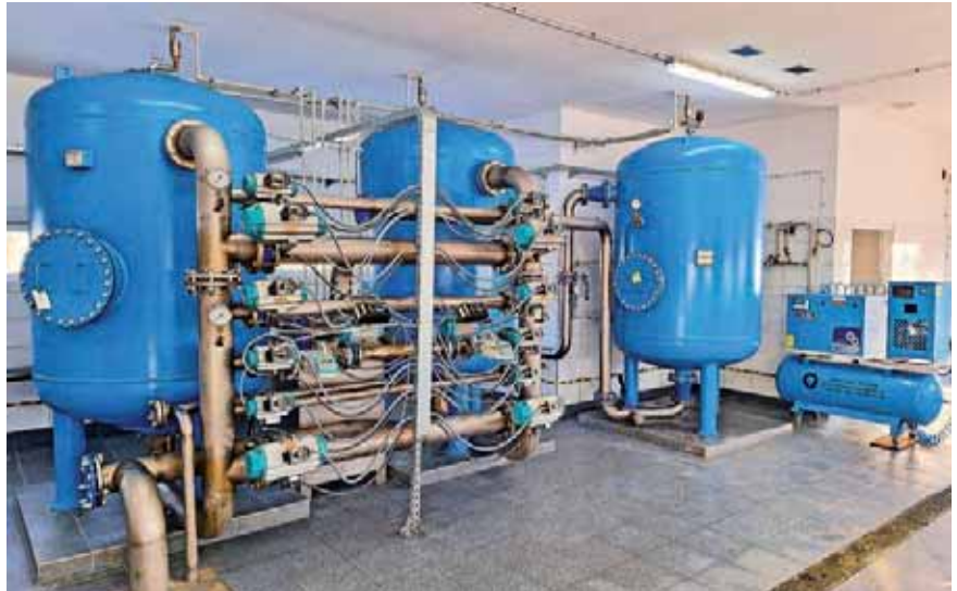
» Nowoczesna Stacja Uzdatniania Wody w Siedlcach
