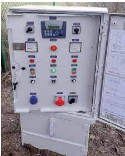
» Jedna z 60 zmodernizowanych do tej pory przepompowni
